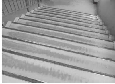
ガムテープで留められた階段滑り止め
