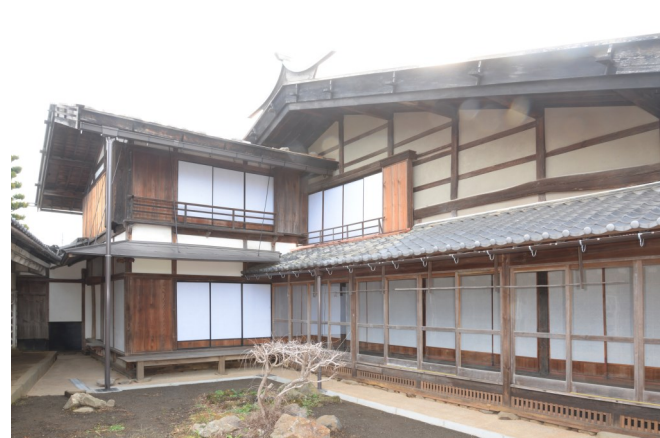
⑤主屋北面 壁面補修、軒下廻り代用叩き、排水溝整備等完了
