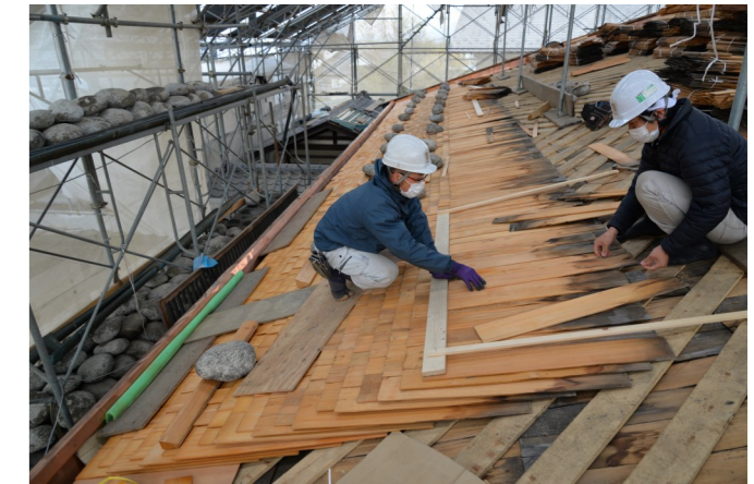
主屋屋根板葺 屋根板は一部在来の葺材を再利用して葺替えを行った。
