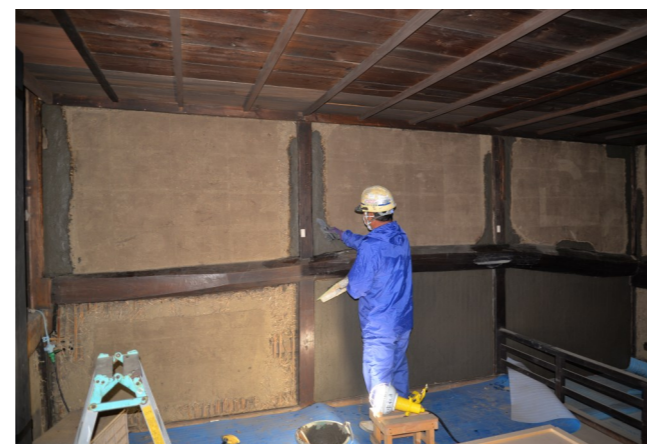
③壁面補修 破損部は補修し、健全部分はそのままとした。
