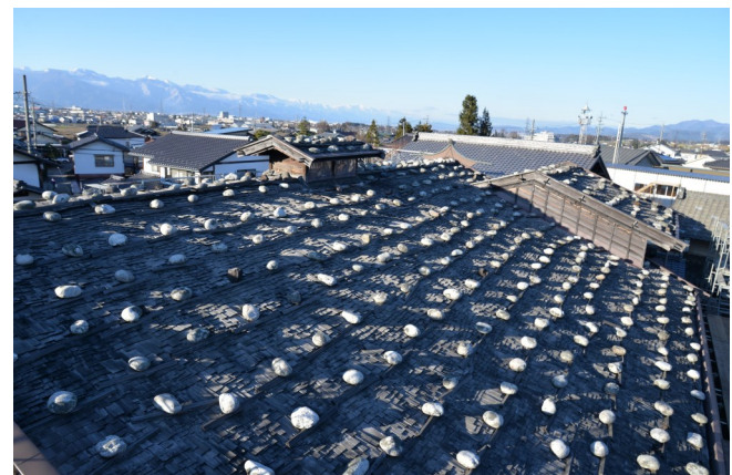
修理前主屋屋根
